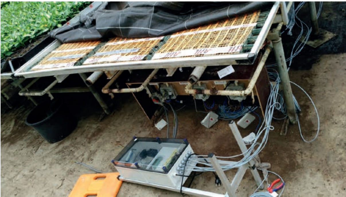
Figuur 1 Tafel met matverwarming, met daaronder de schakelkast met pulsmeters en de datalogger.
