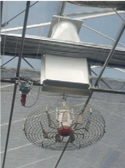
Figuur 1 Ventilation Jet bij Zuiderwijk Witzier.
