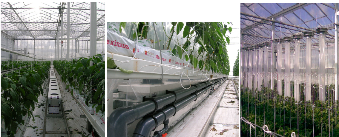
Figuur 1. De JSK installatie zoals geïnstalleerd in afdeling 6.
