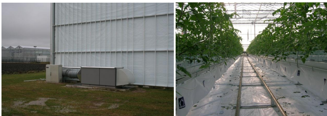
Figuur 3 Links - De luchtbehandelingkast buiten de kas om lucht aan te zuigen voor gecontroleerde ventilatie. In de luchtbehandelingkast zit een ventilator en een warmtewisselaar. Rechts - de luchtverdeelslangen onder de goot.
