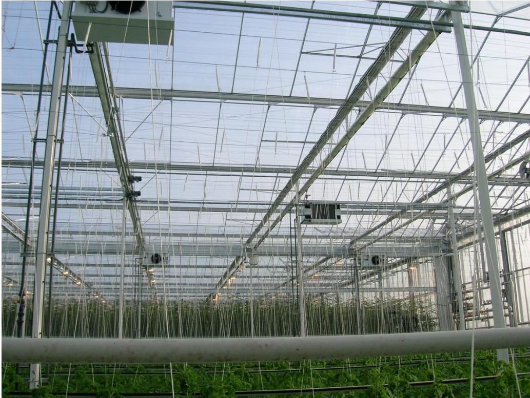
Figuur 4 Koelunits, geïnstalleerd boven het gewas.
