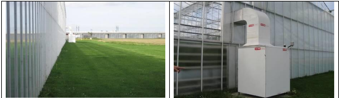
Figuur 16 De LBK van AVS is buiten de kas opgesteld
