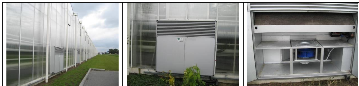
Figuur 13 De CoVent-G luchtbehandelingskast is in de gevel geïntegreerd
