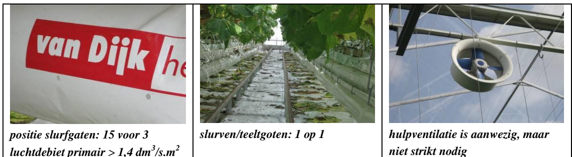
Figuur 17 Luchtslurven onder de teeltgoten en hulpventilatoren bovenin de kas
