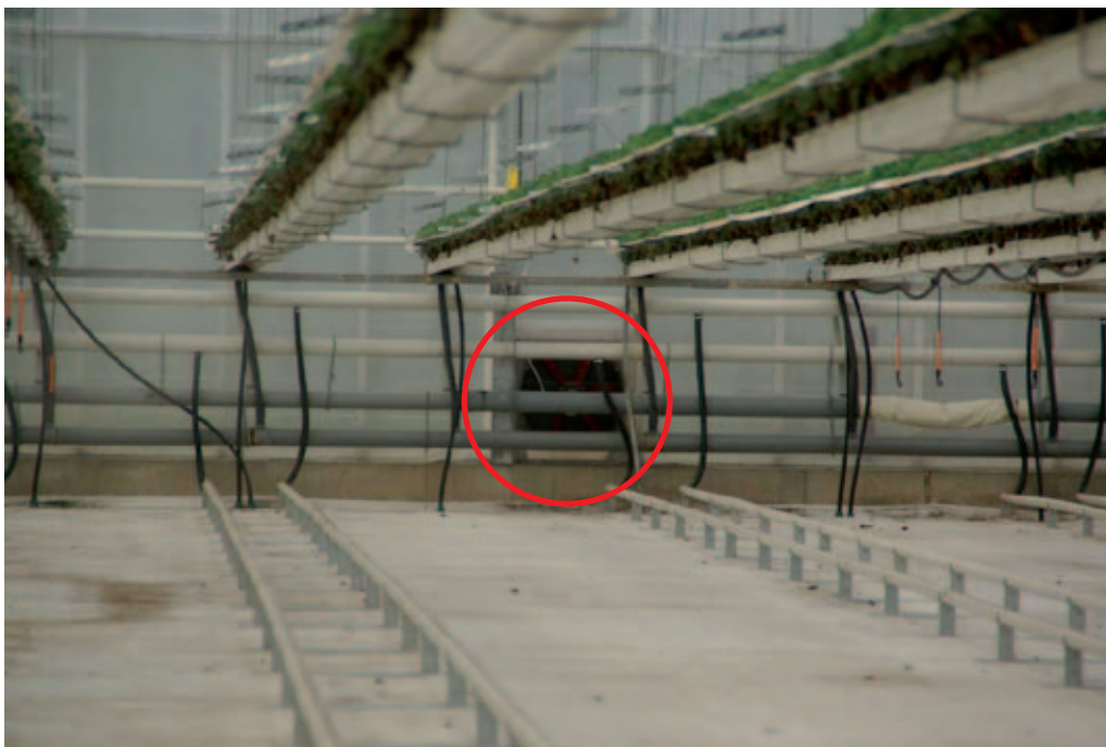
Figuur 2. Inpassing ventilator (rode cirkel) in de buitengevel
