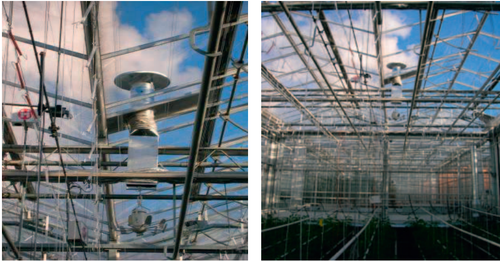
Figuur 3. Links :Overzicht van de kas, met in het midden de Aircobreeze met luchtaanvoer (2009). Rechts achterin de kas zit nog een buitenluchtinblaassysteem dat alleen in 2008 werd gebruikt. Rechts: Close-up van het Aircobreeze systeem: onderin is de ventilator zichtbaar en daarboven het luchtaanvoerkanaal door het kasdek, wat in 2009 is toegevoegd.
