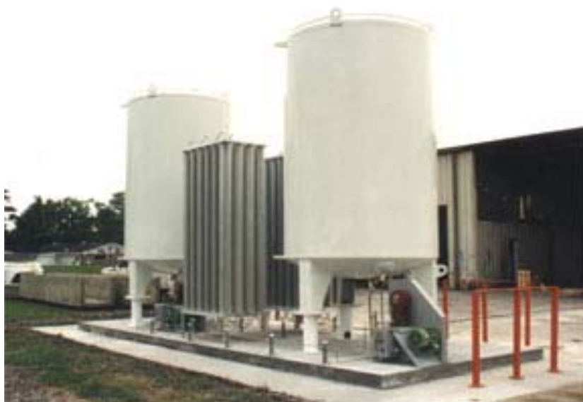
Figuur 7 CO 2 opslagtanks
