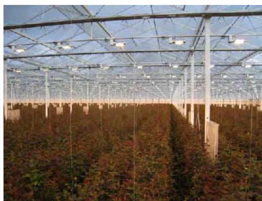
Foto 4 Opstelling koelunits Porta Nova
