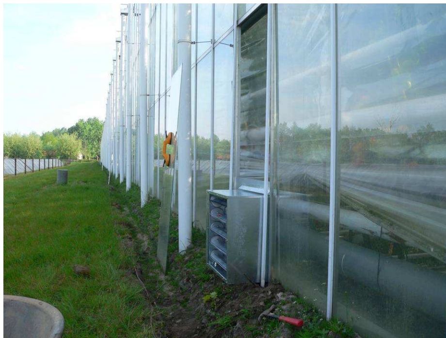
Figuur 13 Ventilator in gevel
