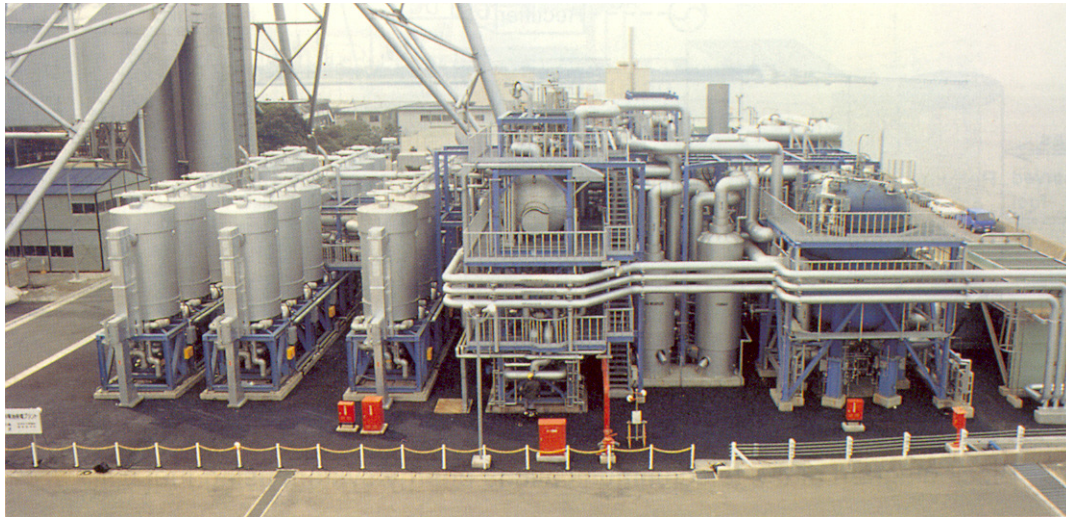
Figuur 6 Het 11 MW fosforzuur brandstofcelsysteem in Goi Thermal Power Station, Japan (FCDIC, 1991)
