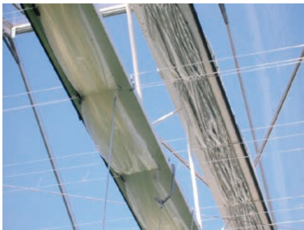
Figuur 1. Het energiescherm (l) en het zware isolatiescherm (r), gebruikt voor de reductie van het energiegebruik.
