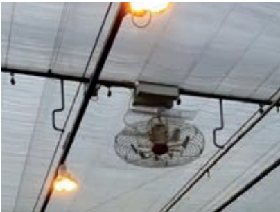
Figuur 1 Ventilationjet met daaronder een nivolorator.
