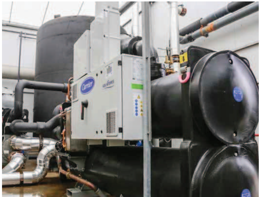
De waterpomp bereikt een hoger rendement nu de aubergineteler het water op hogere temperaturen in de aquifer kan opslaan.
