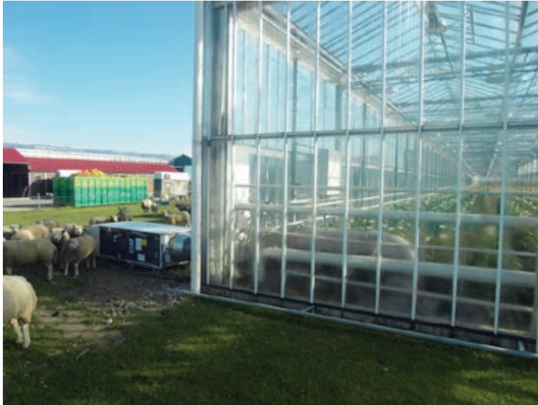
Figuur 2.8. Luchtbehandelingskast buiten.
