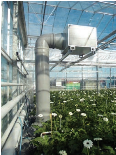
Figuur 2.9 Ventilator voor circulatie kaslucht.
