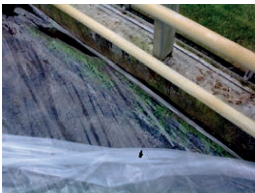
Figuur 10: Onkruidvorming aan de lange gevelzijde onder het plastic
