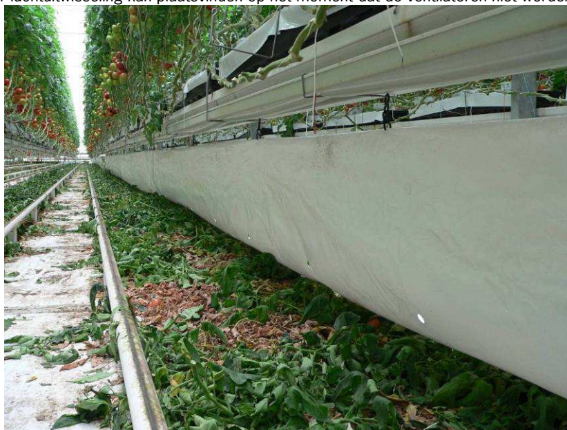
Figuur 14 Luchtslang onder de goot
