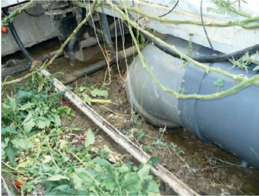
Figuur 3.2. De gedroogde lucht wordt onder de kasvoet door aangevoerd naar de slurven.
