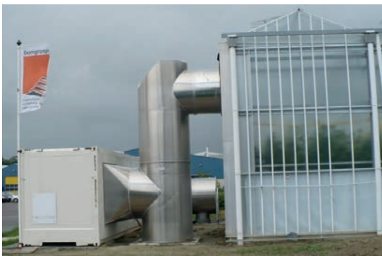
Figuur 3.1. Het experimentele luchtbehandelingssysteem is in een container naast de kas gebouwd. De lucht wordt via één punt aangezogen.
